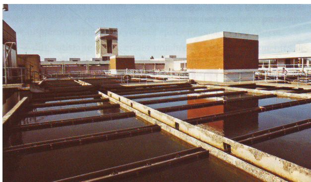
Etape de clarification
